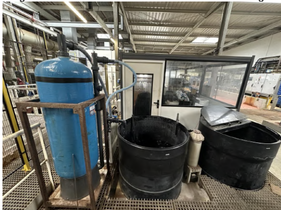
Figure 4 : Station Traitement des eaux usées ressuage
