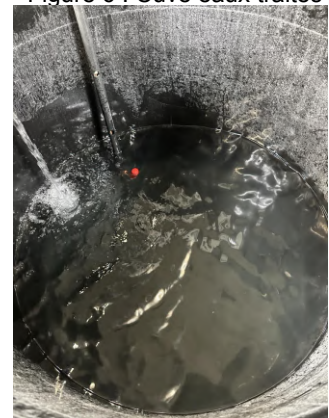
Figure 6 : Cuve eaux traitées
